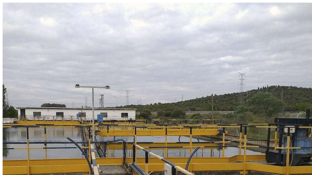
La firma cuenta con estaciones de tratamiento como la de Talavera de la Reina para garantizar la posterior distribución de este recurso a cada casa.
