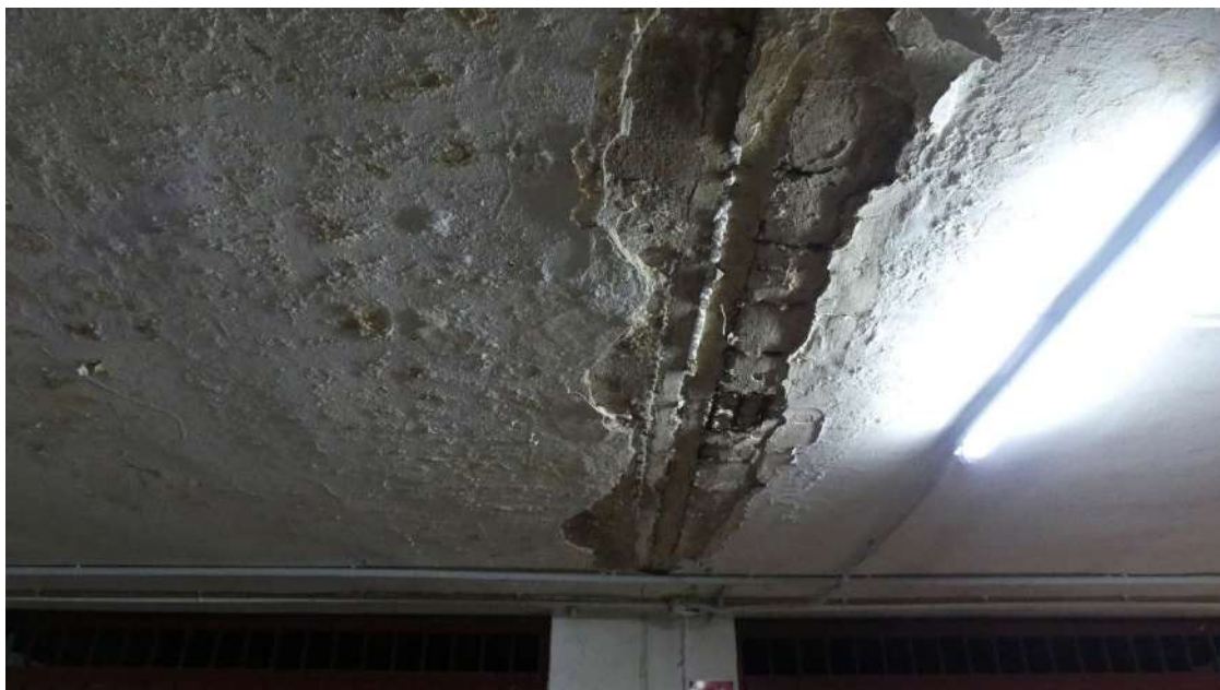
Techo del garaje subterráneo afectado por filtraciones
