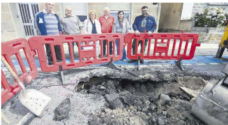
Representantes vecinales y del Concello, ayer, ante el socavón que se está descubriendo. | G.N.
