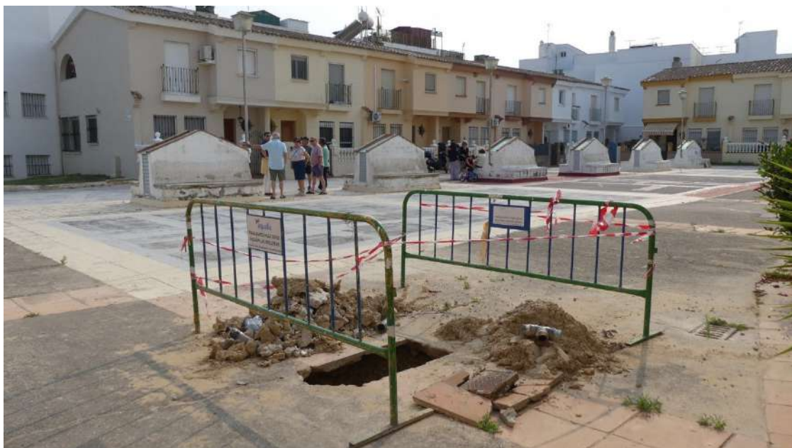
Una de la stres roturas de tubería en una semana
