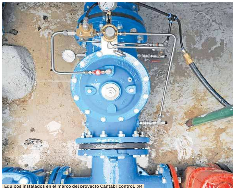
Equipos instalados en el marco del proyecto CantabriControl. DM
